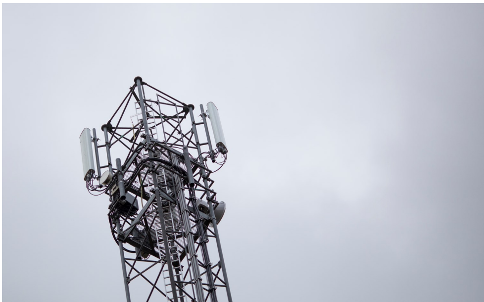
Mobilfunkmast des Testbetriebs in Luckau - Schlabendorf, Quelle atene KOM GmbH
